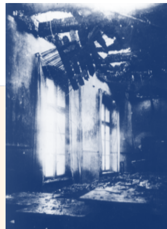
Die ausgebrannte Aula (heutiger Raum 34)
